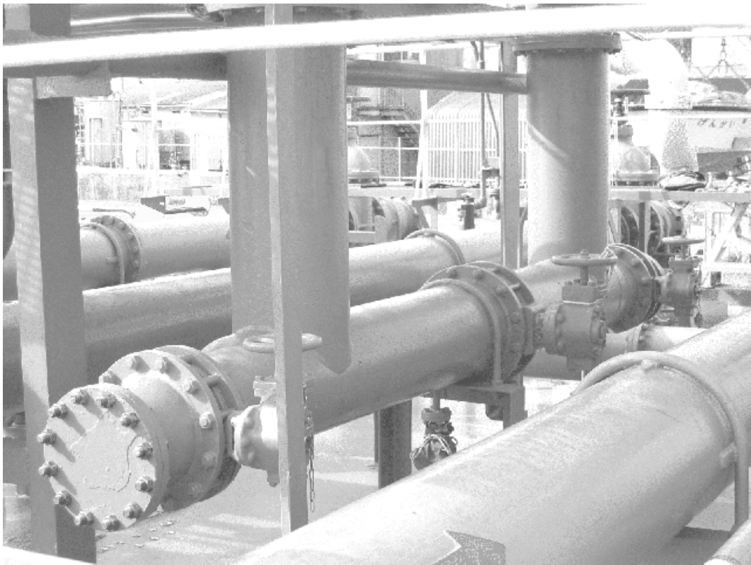
図 22 ベイパーリターン用パイプ(2,000kl 積みタンカーの例)
