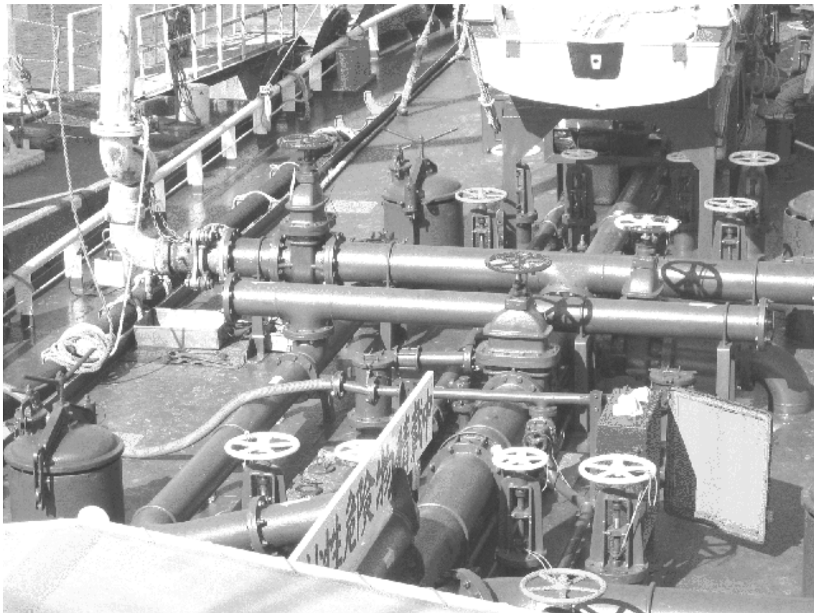
図 23 ベイパーリターン用パイプ(1,000kl 積みタンカーの例)
