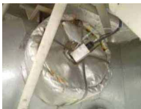
図 5.2.3.2.2.2 NOx/O 2 センサ取付状態
