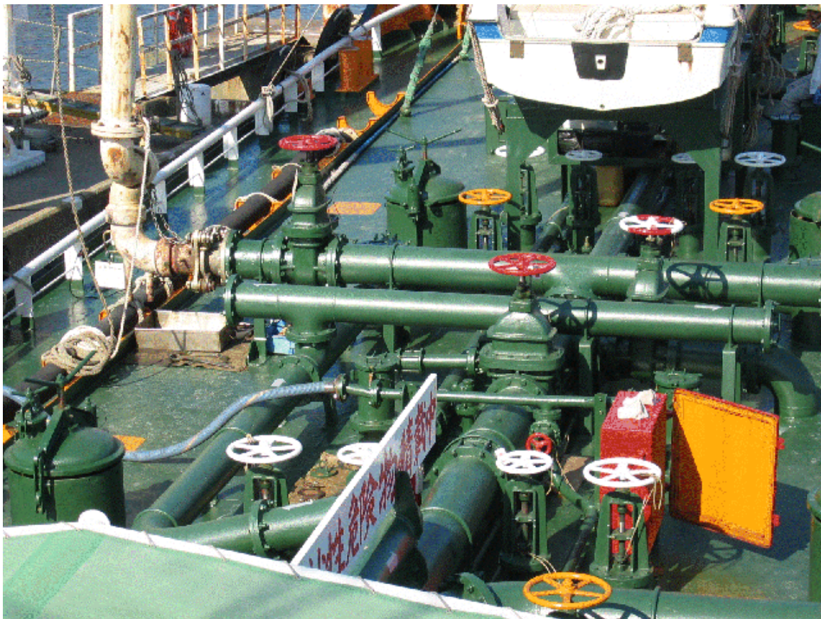
図 20 ベイパーリターン用パイプ(1,000kl 積みタンカーの例)
