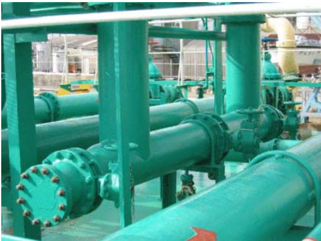
図 19 ベイパーリターン用パイプ(2,000kl 積みタンカーの例)
