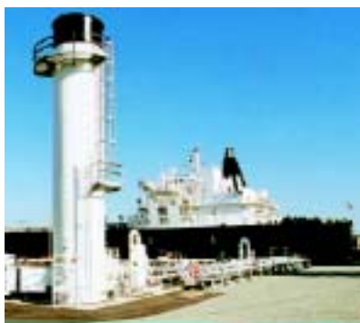
図 36 ふ頭に設置された VOC 処理装置(米国 John Zink 社)
