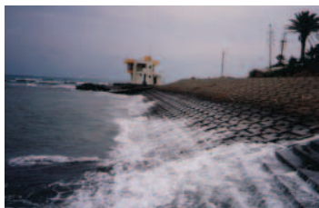
瀬戸浜南部の緩傾斜護岸への波のはいがり状況
